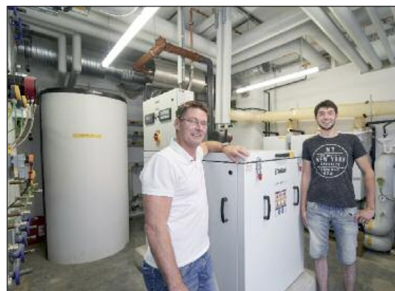
Uwe Langsdorf (li.) und Dean Neugebauer in der Haustechnikzentrale, in der ein Blockheizkraftwerk sowie eine Gas-Brennwert-Kaskade bis zu 400 kW Wärme und 20 kW elektrische Leistung bereitstellen.
